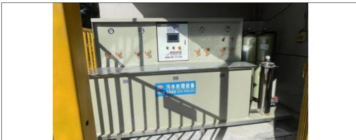
废水处理设施照片
